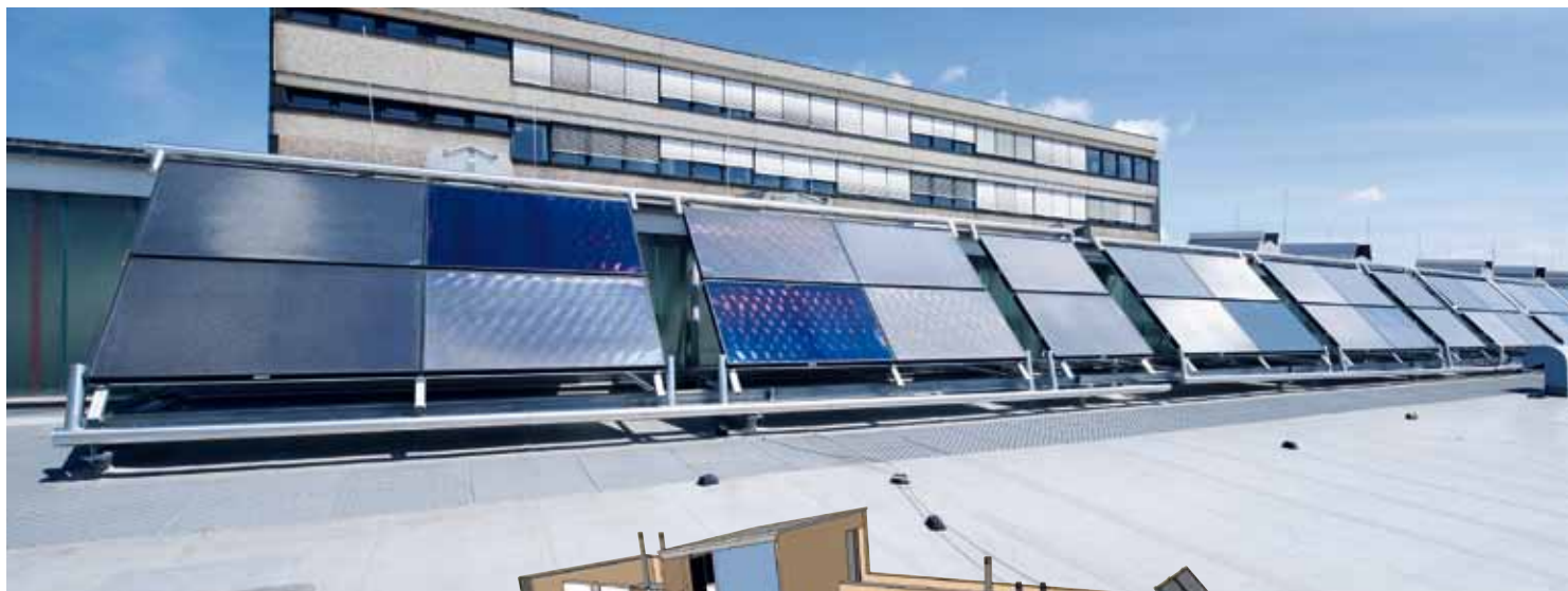
Vaillant Flachkollektoren sorgen für die Warmwasserbereitung in einer Reinigungsanlage des Remscheider Werks.
