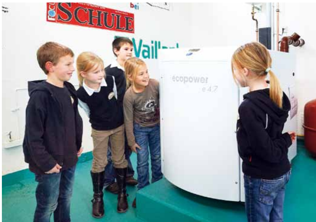
Die Grundschüler aus Moorriem bestaunen das neue Mini-Blockheizkraftwerk Vaillant ecoPOWER.
